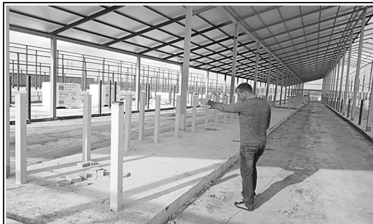
Бригадир С. В. Ильинец поясняет, какое оборудование будет установлено в новом коровнике
